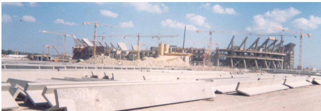
Photo1: Portiques répétitifs des gradins du stade Radès (trame de la construction) et poutres préfabriquées stockés
